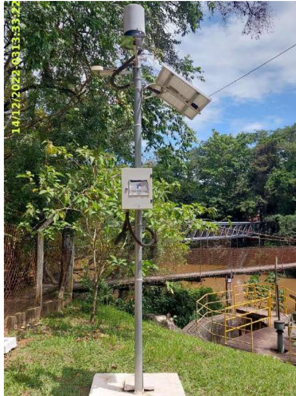
Estação Telemétrica Limpa (perto)
