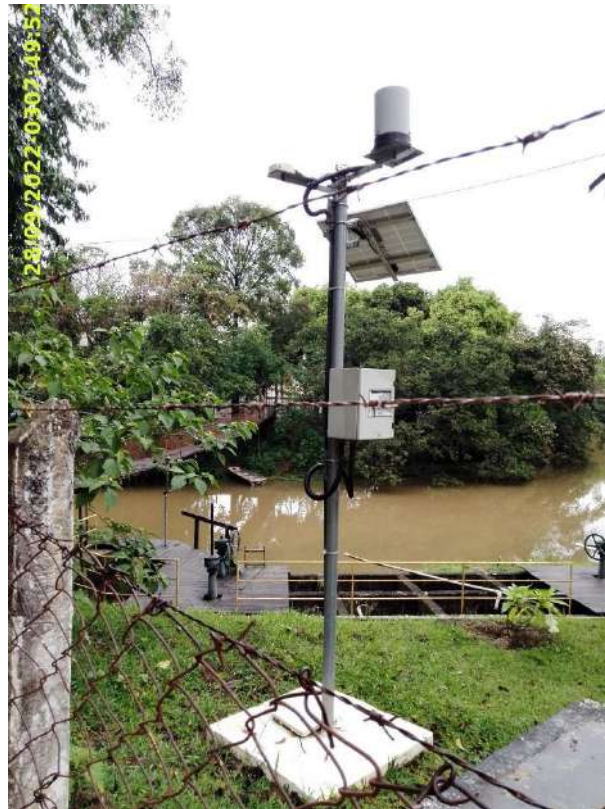
Estação Telemétrica Limpa (perto)
