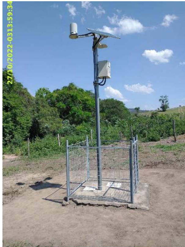
Estação Telemétrica Limpa (perto)
