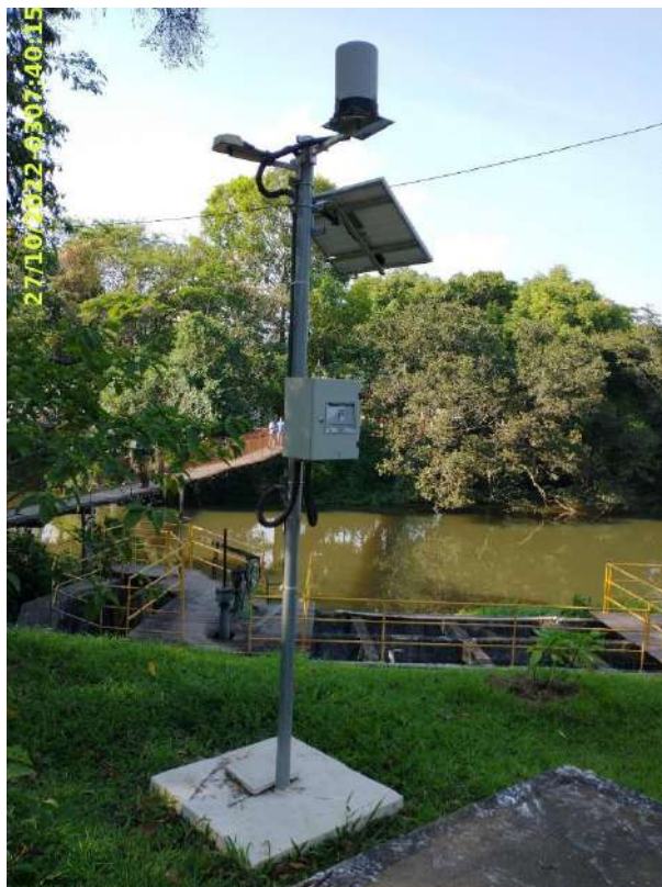
Estação Telemétrica Limpa (perto)
